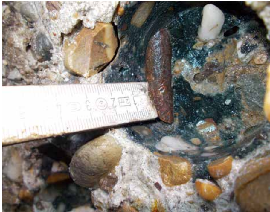
Het boorkernonderzoek op deze foto toont aan dat de overgebleven betondekking zo gering is dat de wapening in de putwand reeds corrosie vertoont.
