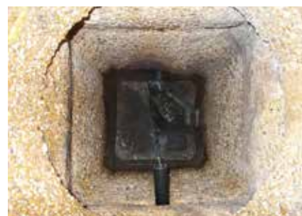
Bij een sterk gecorrodeerde betonnen put is nader onderzoek noodzakelijk om te bepalen of de wapening nog voldoende betondekking heeft.
